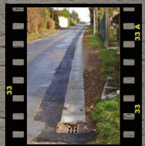
33 33 A Ecoulement des eaux dans la Rue des Chollets
